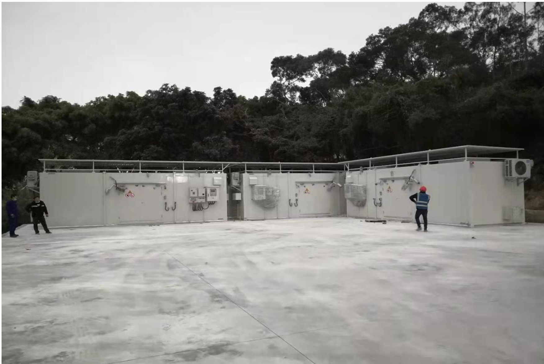
厦门大学---化学品分类分库安全存储
